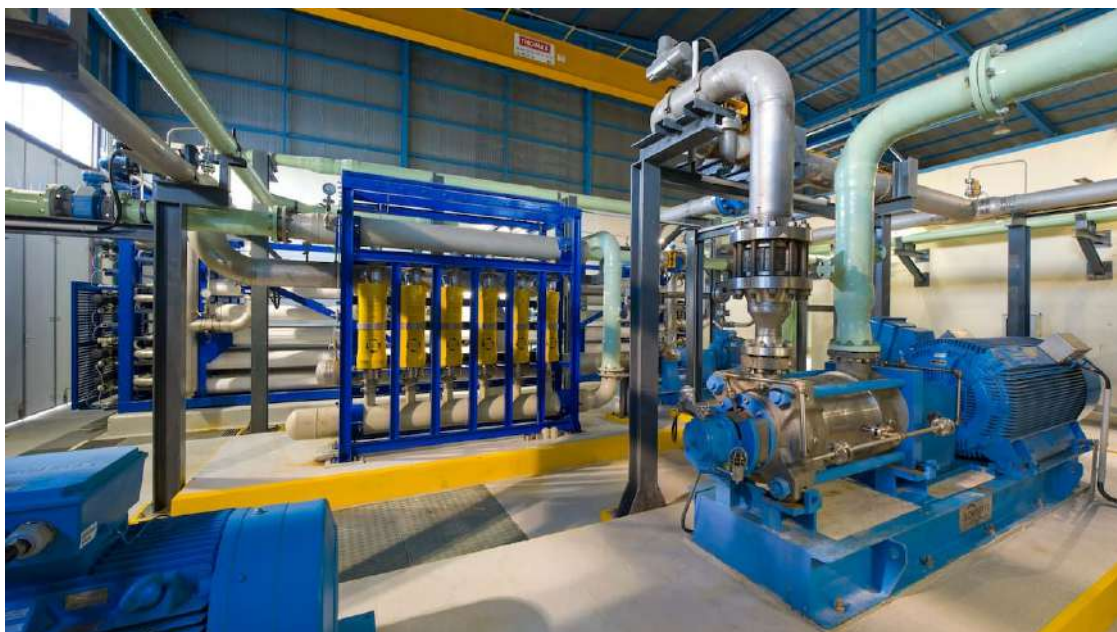
Imagen de una desaladora de Ibiza / Aqualia
