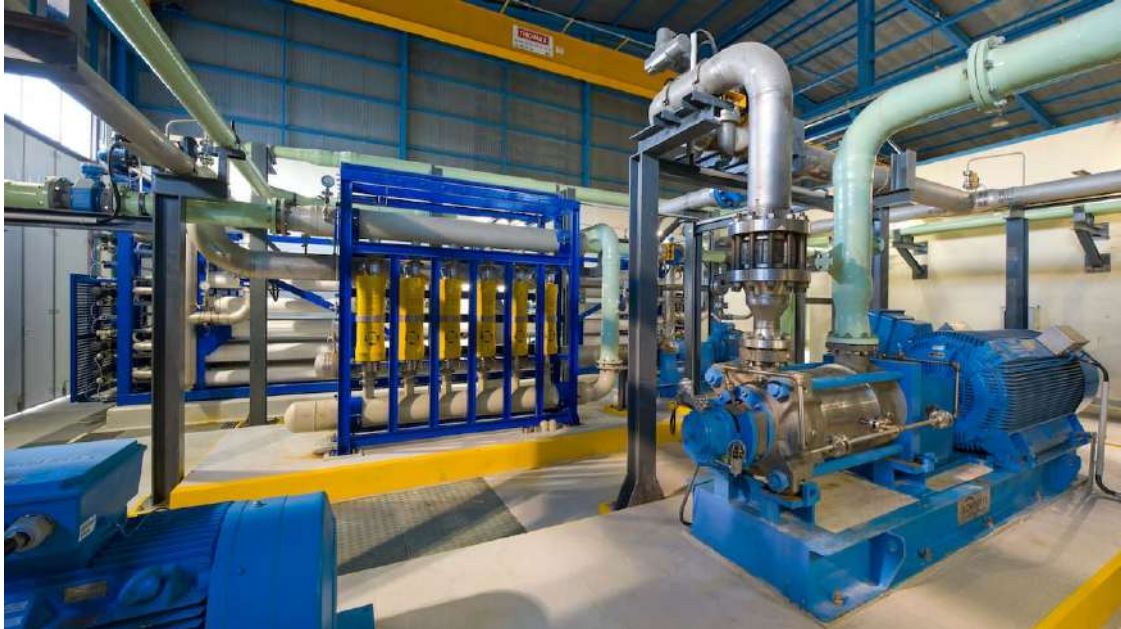
Imagen de una desaladora de Ibiza / Aqualia
